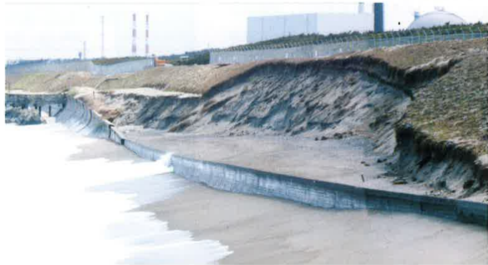
写真-1 被災直後の状況
