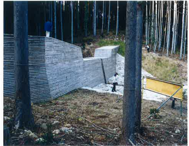
修景残存型枠を使った砂防ダム
