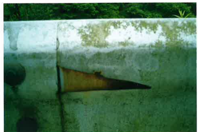
ガードレールの金属片
