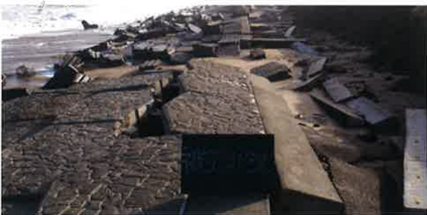
被災直後の状況(日立市十王町伊師地区)
