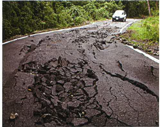
被災した林道酒寄線(平成20年8月)
