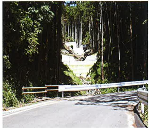
竣工した谷止工(平成20年～21年度施行)と 林道平野線(平成20年度施行)
