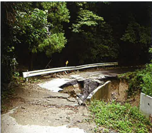
被災した林道平野線(平成20年8月)
