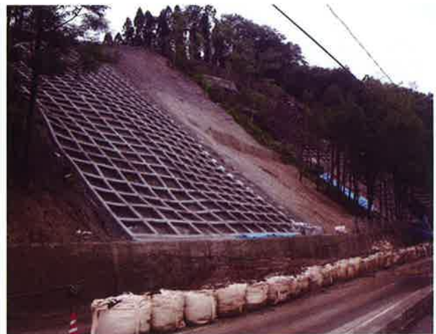
写真1 山腹崩壊復旧状況 (高萩市下君田)
