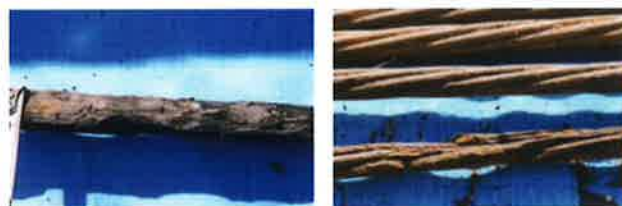
アンカー鋼材が腐食している様子
