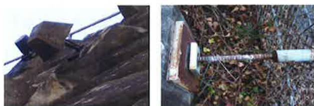
アンカー鋼材が飛び出している様子
