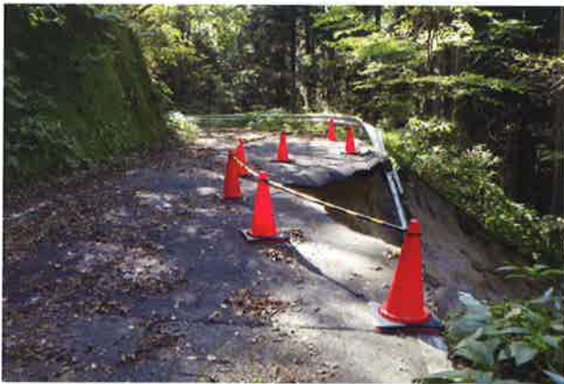
写真4 路肩の崩壊状況 (林道：大能・米平線)
