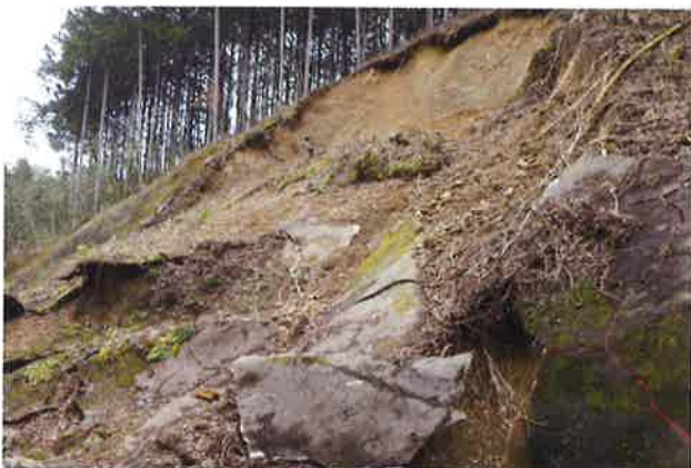
写真5 法面の崩壊状況 (林道：道口神線)
