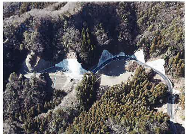
林道工事「奥久慈グリーンライン林道武生線開設」 海老根建設(株)
