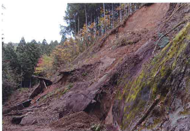
法面の崩壊による被災状況 (林道：道口ク神線)
