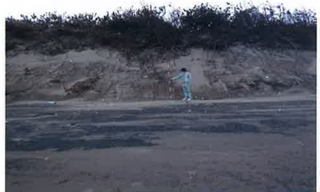
波浪により荒廃した海岸防災林（5か年加速化対策における新規着手箇所の1つである銚田市台濁沢地区）
